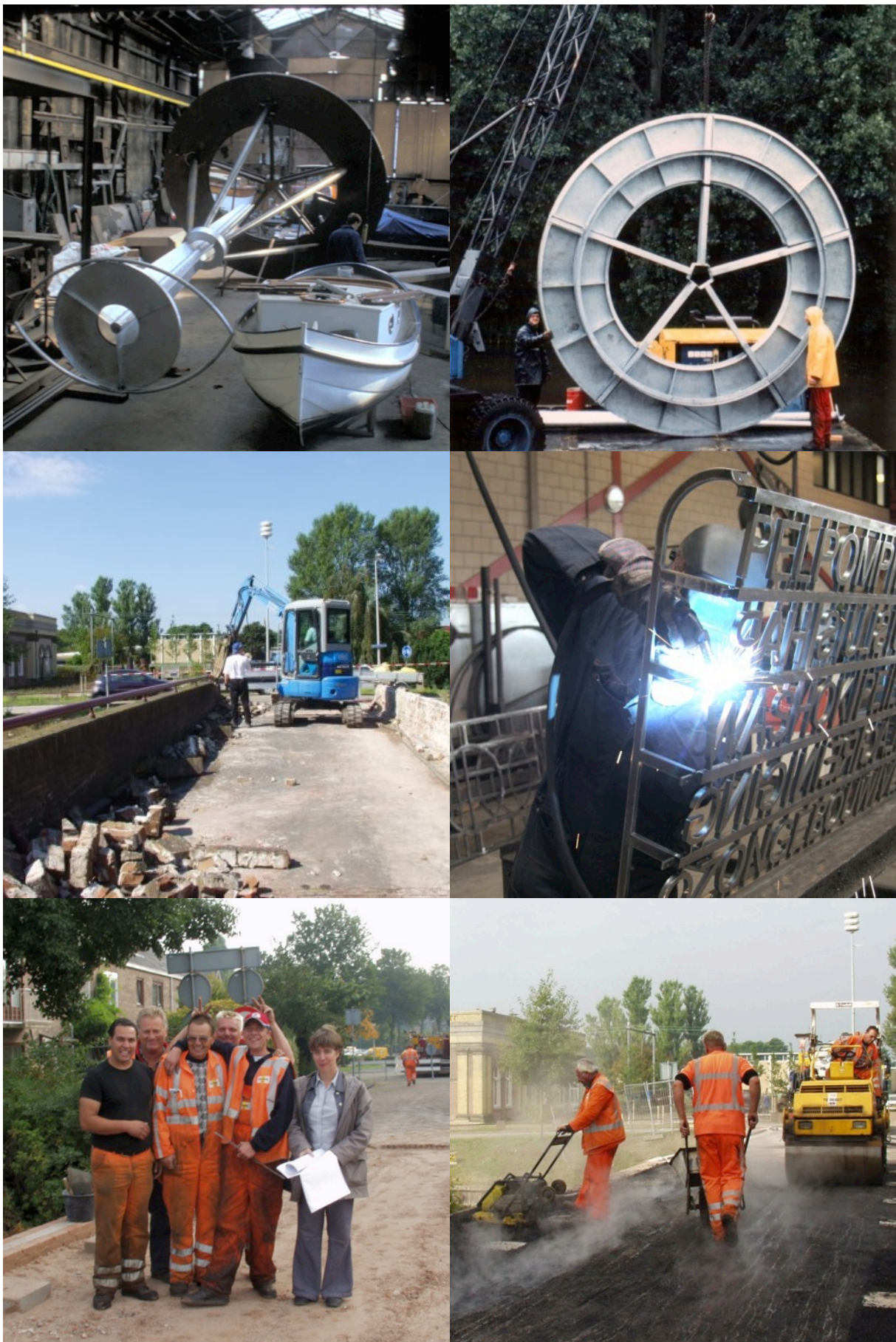
Boven: werk aan Kijker op scheepswerf en plaatsing boven water van Nobelweg/Hugo de Vrieslaan Amsterdam. Midden en onder: werk aan Drinkwater Leidse Vaart Heemstede. Links: sloop oude noodbrug Leidsevaart Heemstede; las- en constructiewerk fabriek. Onder overleg met hoveniers en asfalterders en het asfalteren zelf.
